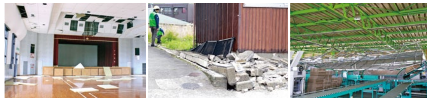
北有馬ピロティー文化センター日野江の吊り天井パネルが落下
