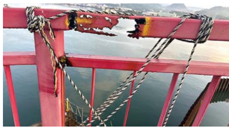
腐食したなんばん大橋
