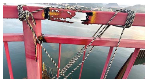
腐食したなんばん大橋
