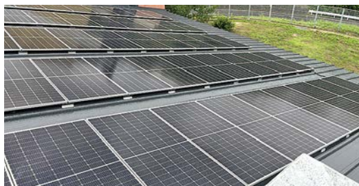
太陽光パネル
