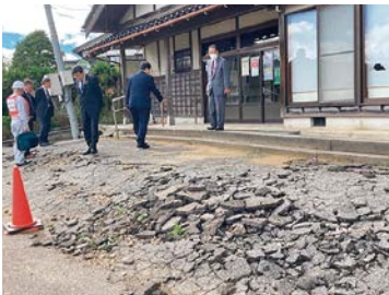
【現地視察】「宝達志水町内の被害状況」
