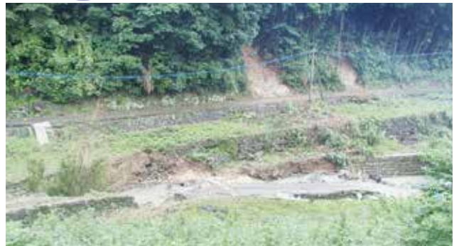
公共土木災害現場 井龍川
