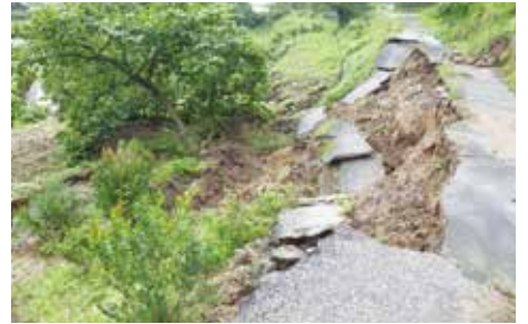
大雨による土砂崩れ
