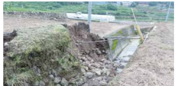
豪雨による土砂崩れ
