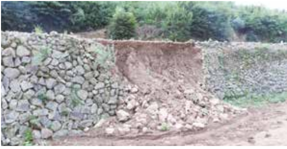
豪雨により崩れた畑
