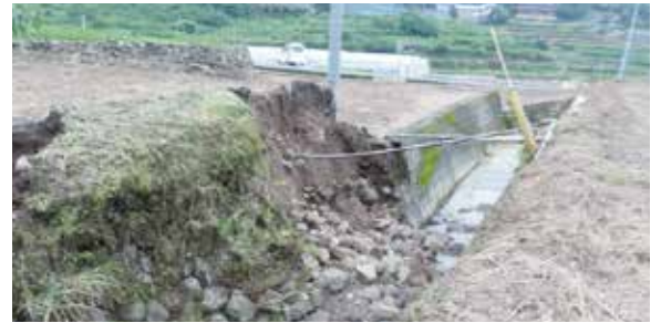
豪雨による土砂崩れ
