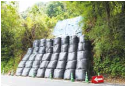
豪雨による土砂崩れ（坂下公民館付近）
