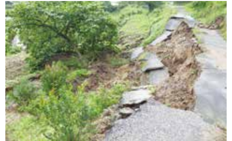
大雨による土砂崩れ
