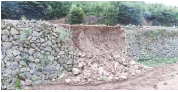
豪雨により崩れた畑
