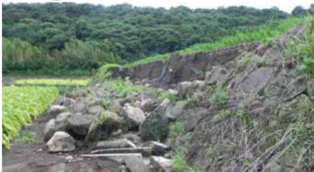
農業施設災害現場
