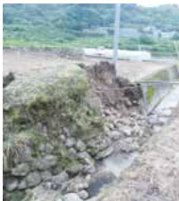
平成28年6月豪雨時被害
