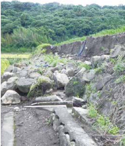
平成28年6月豪雨被害
