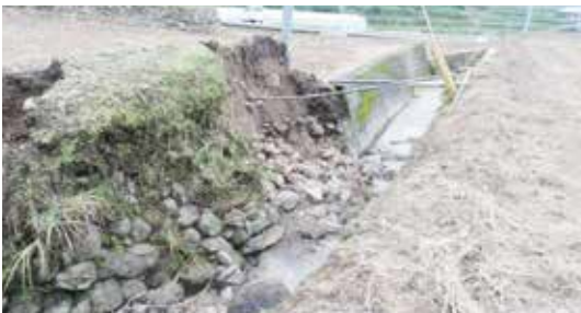
豪雨による被害
