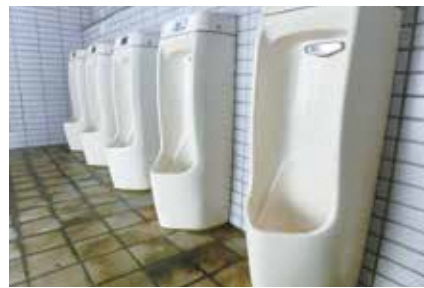
深江運動場トイレ（業者清掃後）
