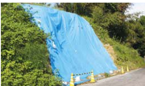
原城跡法面崩落現場
