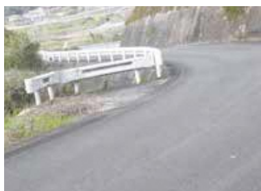
消えた道路の区画線
