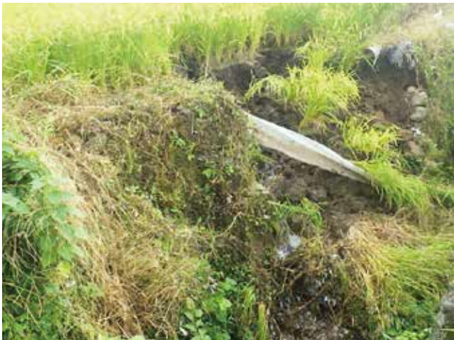
農業用施設災害（水路）
