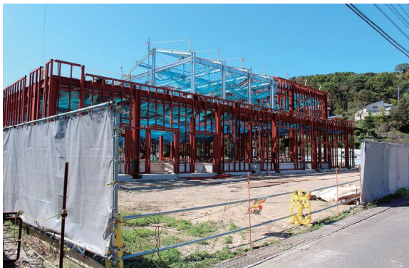
工事進行中の新学校給食センター (旧龍石小学校跡地 西有家町)
