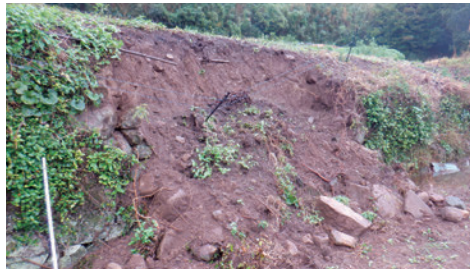
台風による市道路肩の崩壊
