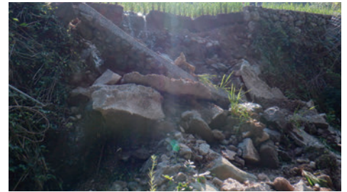
台風による河川護岸の崩壊
