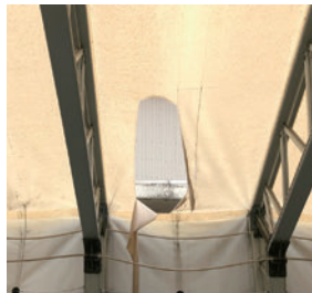
台風による口之津プールテントの破損
