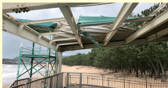
加津佐前浜海水浴場棧敷被災箇所
