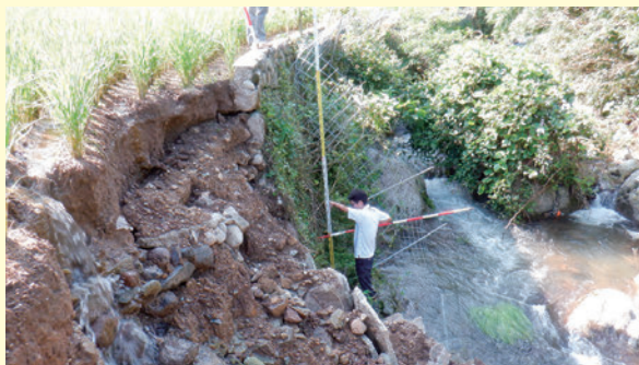
河川被災箇所(有家町)
