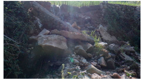
台風による河川護岸の崩壊
