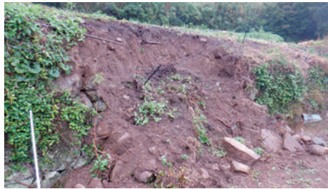
台風による市道路肩の崩壊
