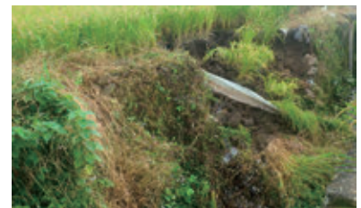
農業用施設災害（水路）
