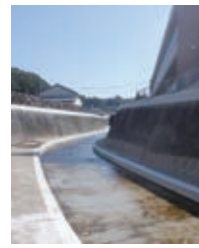
緊急自然災害防止対策事業 井龍川（西有家町）
