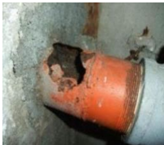
劣化による配管破損
