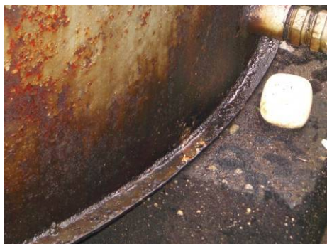
①. 重油タンクの腐食
