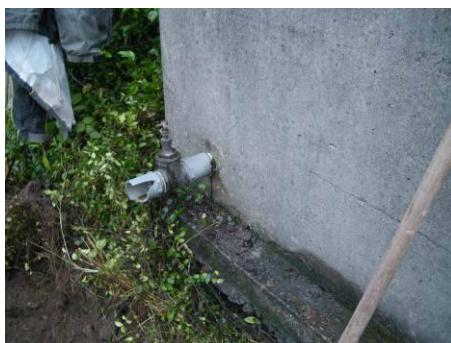
②. 防油堤のひび割れとバルブ
