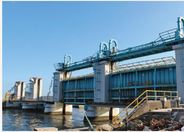
津波で全壊した八幡川水門
