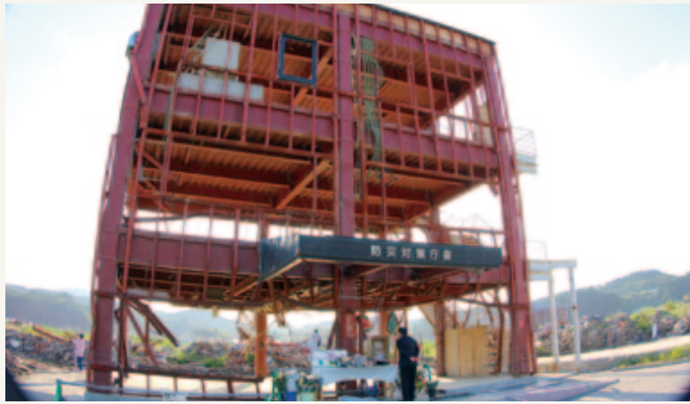
南三陸町「防災対策庁舎」
