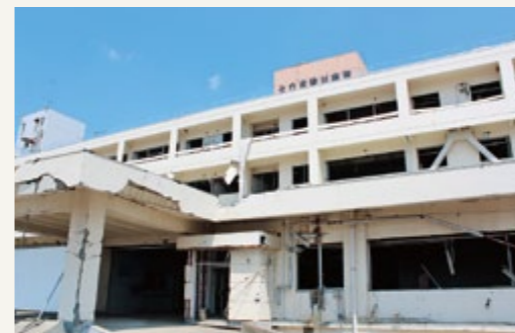
地域の基幹病院である公立志津川病院の被害状況
