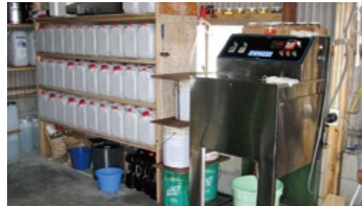
廃油(植物油)からバイオ燃料を製造するBDF製造施設(社会福祉法人ほかにわ共和国)。施設の車両の燃料として利用している。
