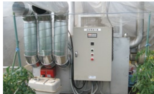
農業用ハウス加温チップボイラー(南有馬町)。建築廃材からできたチップを使う。
