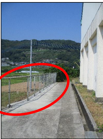
↑ 体育館裏フェンスをまっすぐに立て直す工事をしてもらいました。
